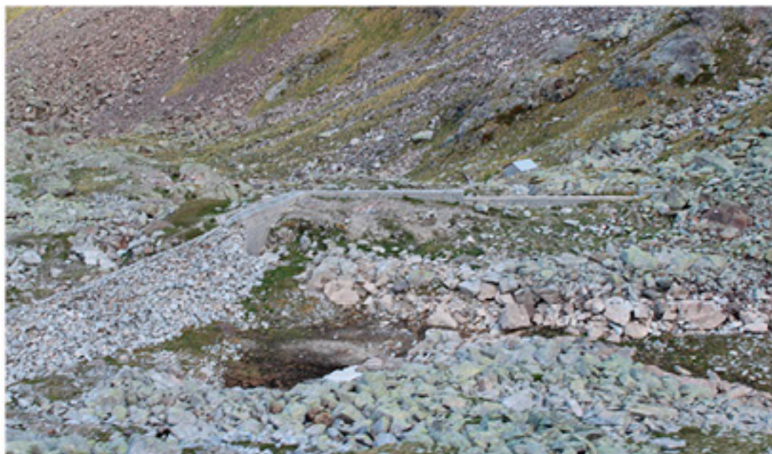
LAGO LUNGO, SI INTRAVEDE IL MURO DELLA PICCOLA DIGA OGGI IN DISFACIMENTO (FOTO D. ROMELLI)
