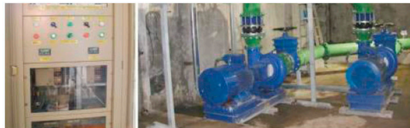
POMPE VUOTA LAGO E RECUPERO PERDITE DELLA DIGA
