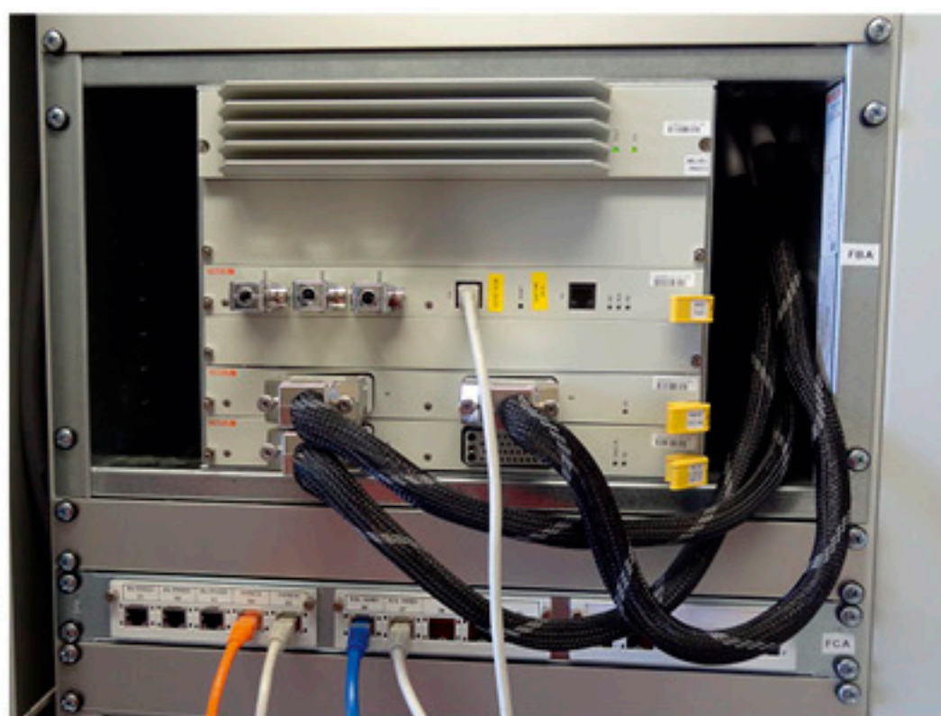
APPARATO ESSDI (ELABORATORE (PER LA) SORVEGLIANZA STATICA (DELLE) DIGHE)
